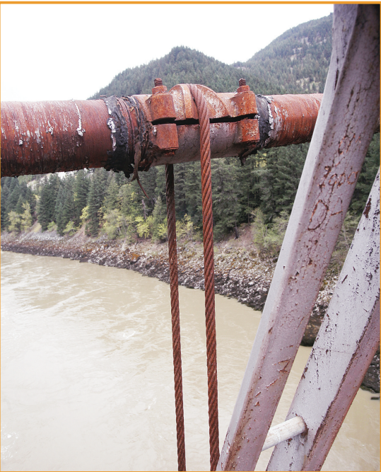
▲橋樑的金屬部件鏽蝕嚴重。
