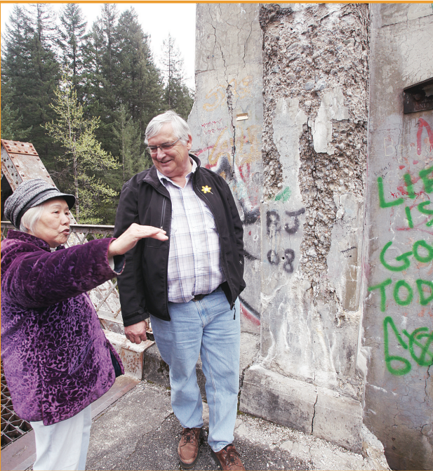
▲蔡小珊（左）雷蒙德視察橋樑破損情況。（陳志強攝）
