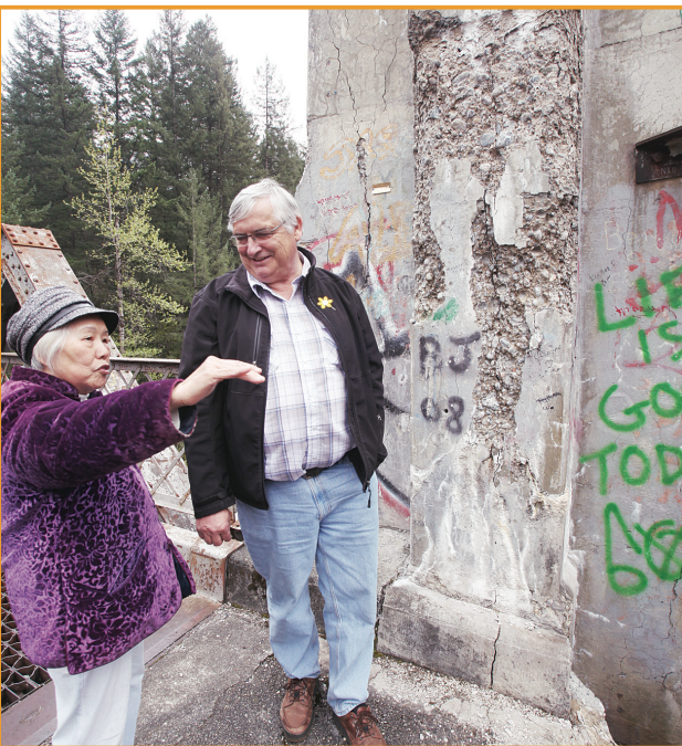
▲蔡小珊（左）雷蒙德視察橋樑破損情況。
