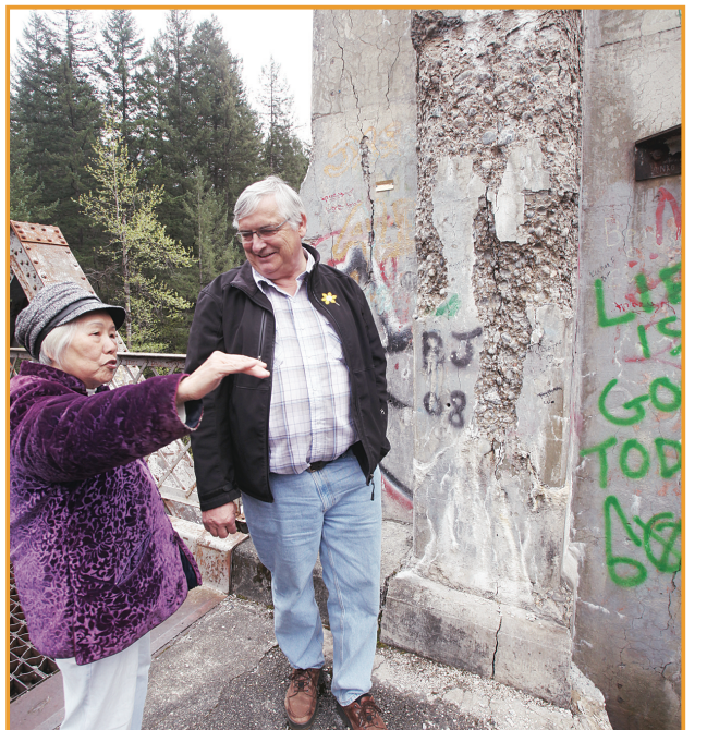
▲蔡小珊 (左) 雷蒙德視察橋樑破損情況。
