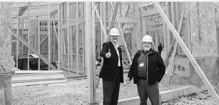
畢貝爾 (左) 和 Frank Everitt 在四川省北川縣一間正在施工的老人院前合照。(卑詩省政府提供)
