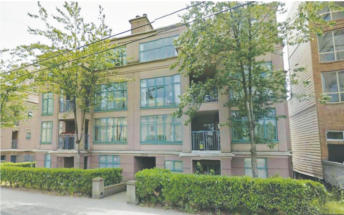
「嘉湖花園」獲法官下令對業主收取1680萬元的維修漏水費用。
