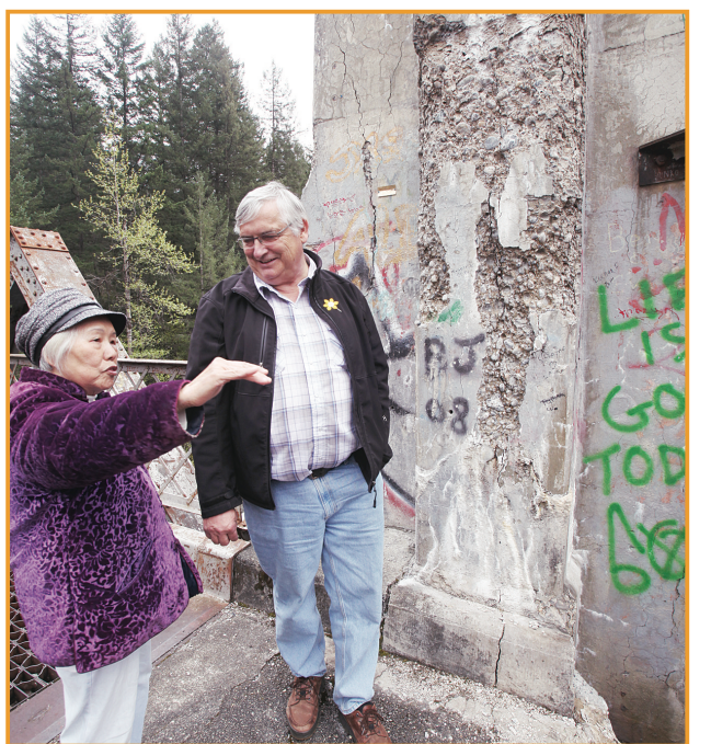
▲蔡小珊 (左) 雷蒙德視察橋樑破損情況。
